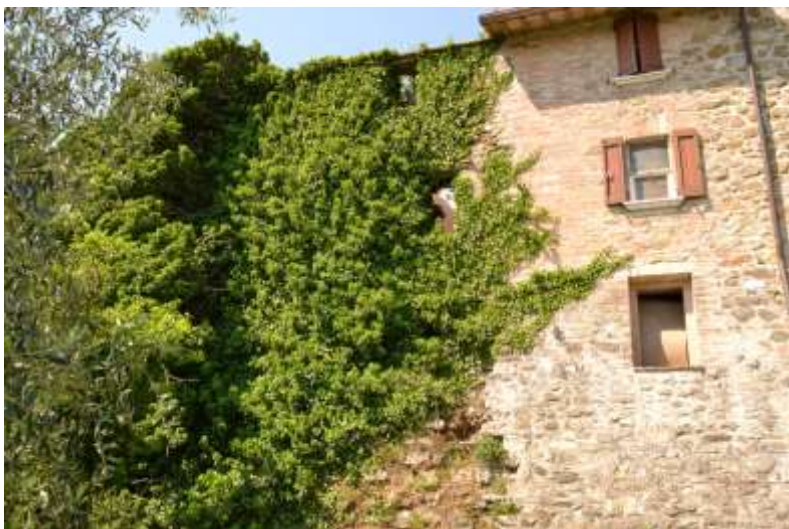
Figura 12 - Edificio abbandonato in forte stato di degrado
